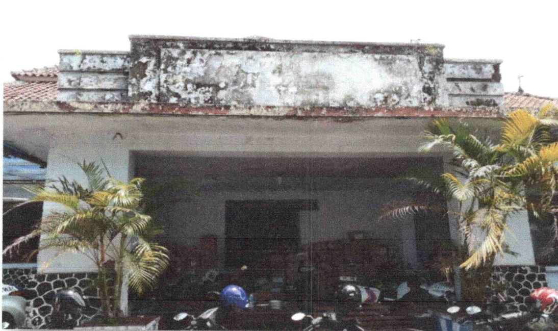
Foto 3. Fasade depan Gedung Kantor Satlantas Polres Banyumas, terlihat foto fokus pada teras yang kontruksi atapnya telah berumur (Sumber: Dokumentasi TACB Kab. Banyumas)
