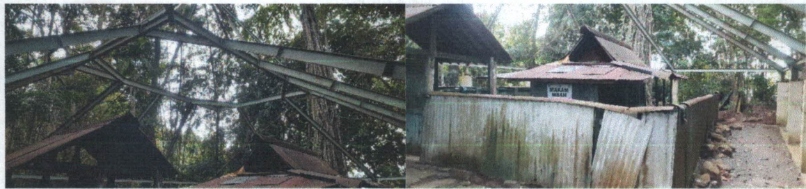
Foto 13 Struktur penutup atap makam Foto 14 Kondisi pagar dan cungkup Dok. TPCB Kab. Banyumas 2025
